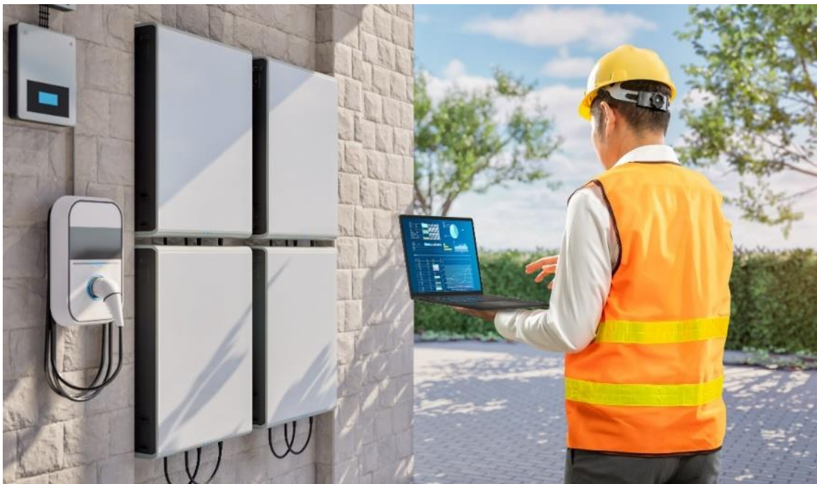
Figuur 12: : Installatie van een EV-lader met Energieopslag systeem (ESS) voor thuisgebruik. Foto: Shutterstock
